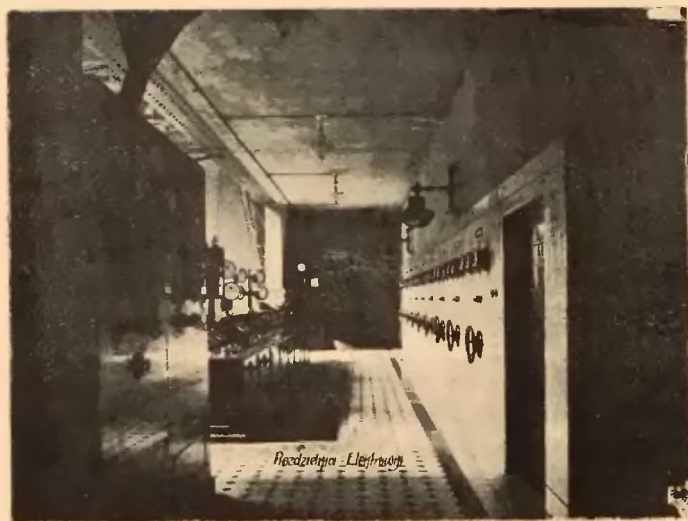
Elektrownia Okręg, Żagł. Dąbrow. Rozdzielnia.
