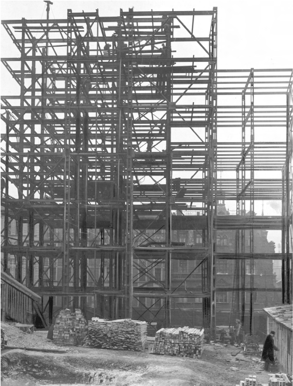
Fot. 5. Dom dla profesorów Śląskich Technicznych Zakładów Naukowych przy ul. Wojewódzkiej w Katowicach; proj. Eustachy Chmielewski. Widoczny szkielet konstrukcyjny budynku (zbiory Narodowego Archiwum Cyfrowego, sygn. 1-N-2321)
