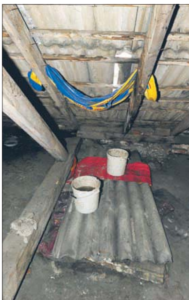
Aby przeżyć, trzeba łapać wodę do wiadra, bo inaczej mieszkanie zalane
