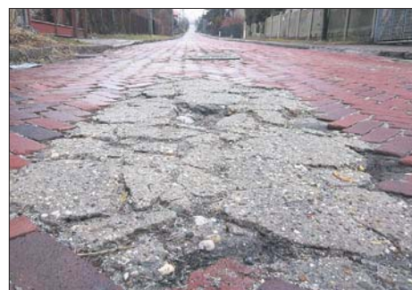
Betonowy wtręt. Działkowa 3
