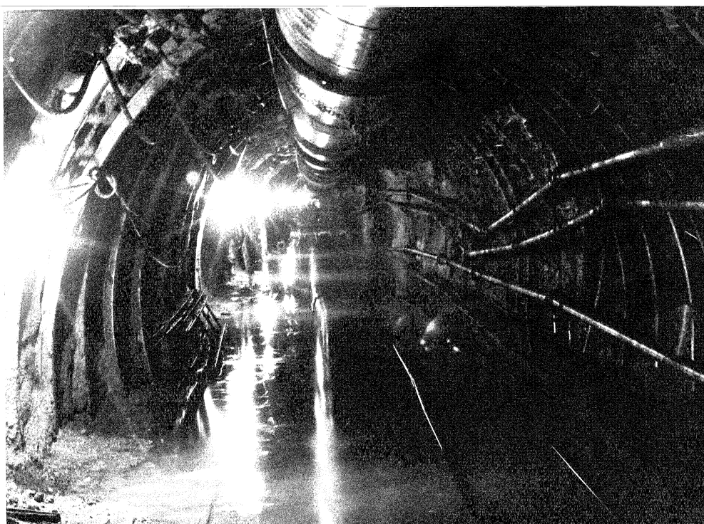
Foto. 16. Jedno z miejsc pracy studentów – sztolnia wodna „Burkersdorf” po awarii pomp odwadniających
