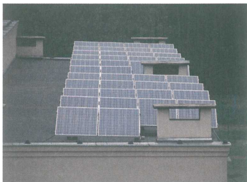
34. Zabrze, Szyb Maciej, kolektory fotowoltaiczne na dachu Stacji Wodnej, fot. D. Żabicka-Barecka 2013 r.
