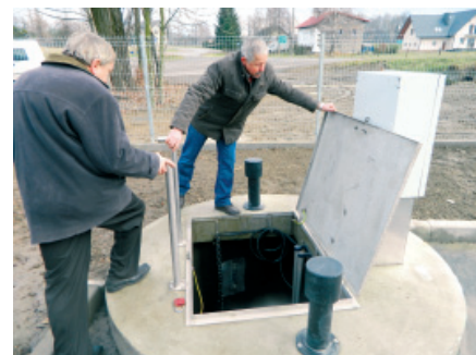
Jednym z ważnych urządzeń sieci kanalizacyjnej jest nowoczesna pompownia.
