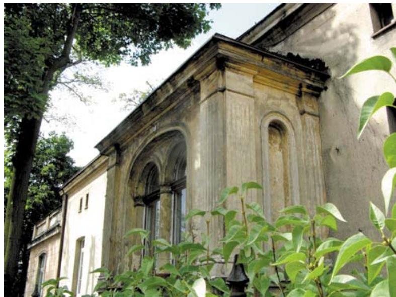
Dawna plebania była zabytkiem. W jej miejsce stanie podobno budynek, który wizualnie będzie przypominał historyczną siedzibę ewangelików.
