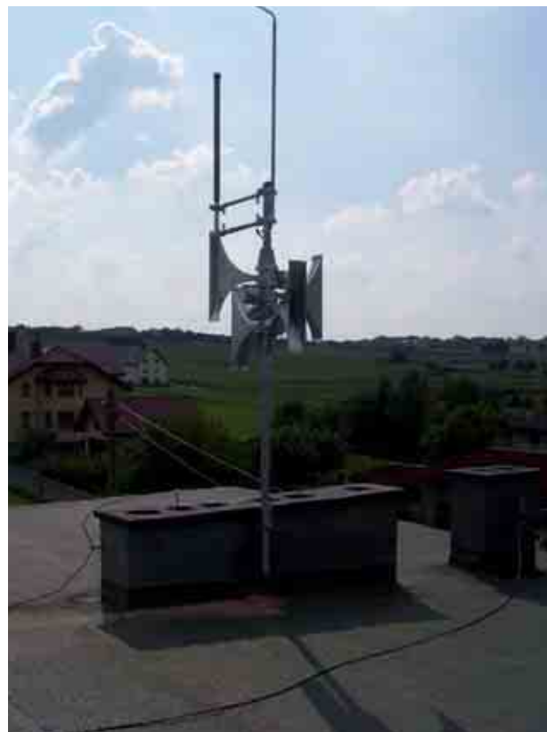
Syrena elektroniczna typu DSE-600S
