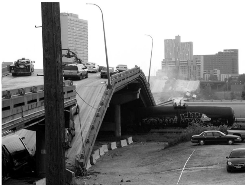
Rys. 8. Zawalony most autostrady w stanie Minneapolis, USA.
