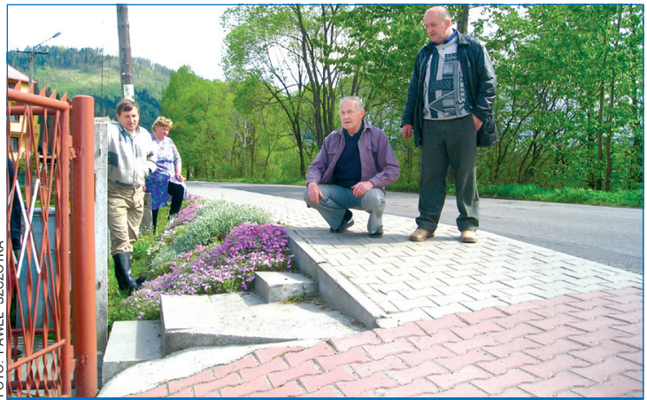
- I to robili fachowcy? - zastanawiają się mieszkańcy Górnej Miłówki, którym woda z chodnika wlewa się na posesje.
