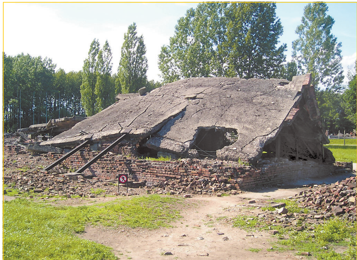
Krematorium nr II. Część ruiny została podparta drewnianymi stemplami.
