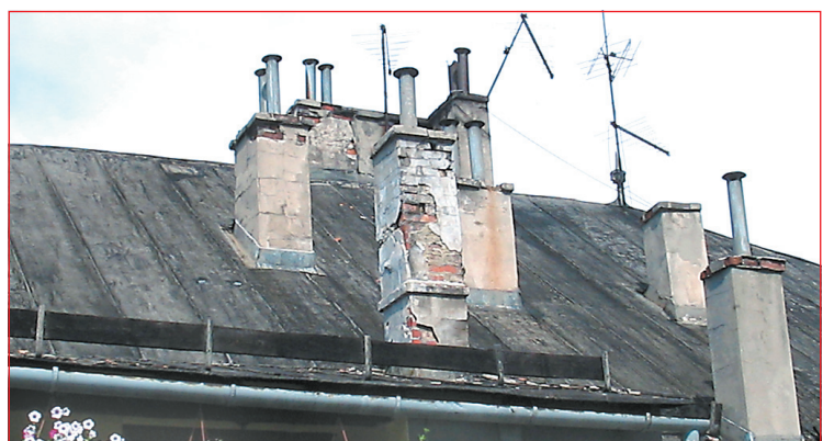
Rozsypujące się kominy i wszędobylski grzyb, to znaki rozpoznawcze czekającej na remont kamienicy przy ulicy Karpackiej 7.
