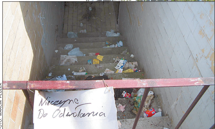
Schody do szaletu są pełne śmieci, co kontrastuje z zadbanym otoczeniem dworcowego budynku.
