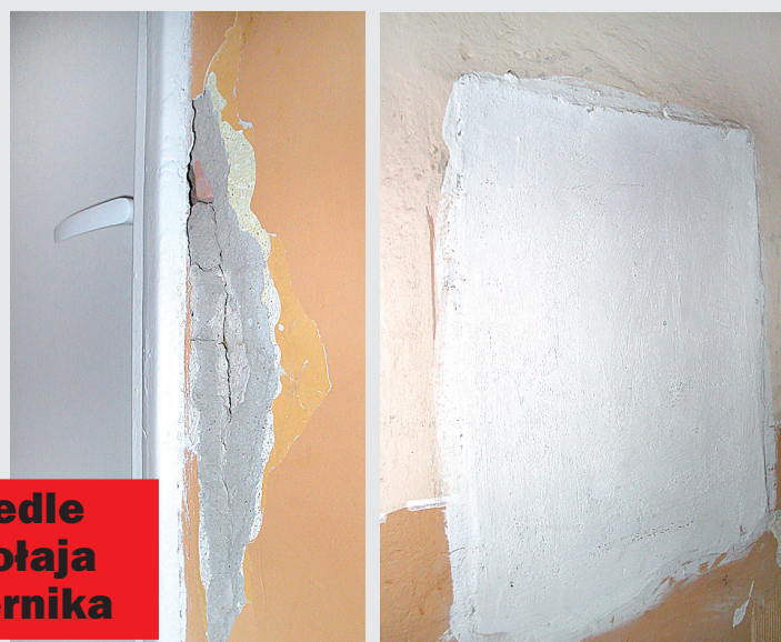
W bloku przy ulicy Wiśniowej 19 można znaleźć zarówno dziurę w ścianie, jak i ślady murarki w postaci estetycznego potworka.
