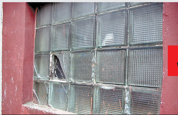
Wejście do bloku przy ulicy Spółdzielców 39 straszy oskubanym tynkiem i zniszczonymi luksferami.
