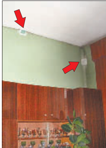
...a w sąsiednim mieszkaniu pękają ściany.
