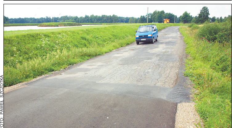
Tak wygląda zniszczony fragment drogi prowadzącej z Zaborza do Grojca.
