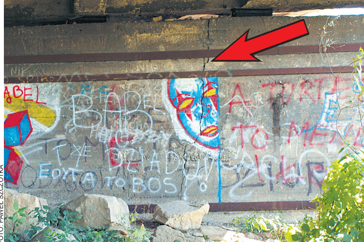
Pęknięcie na jednym z filarów mostu.
