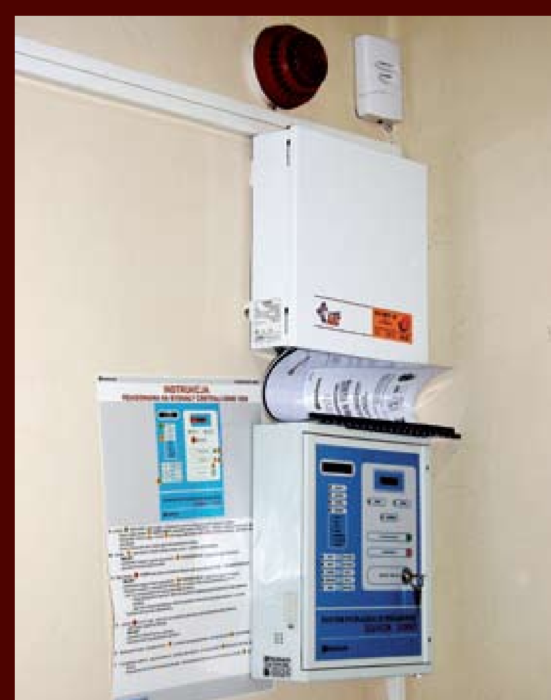
Zainstalowana w Muzeum centrala systemu sygnalizacji pożaru
