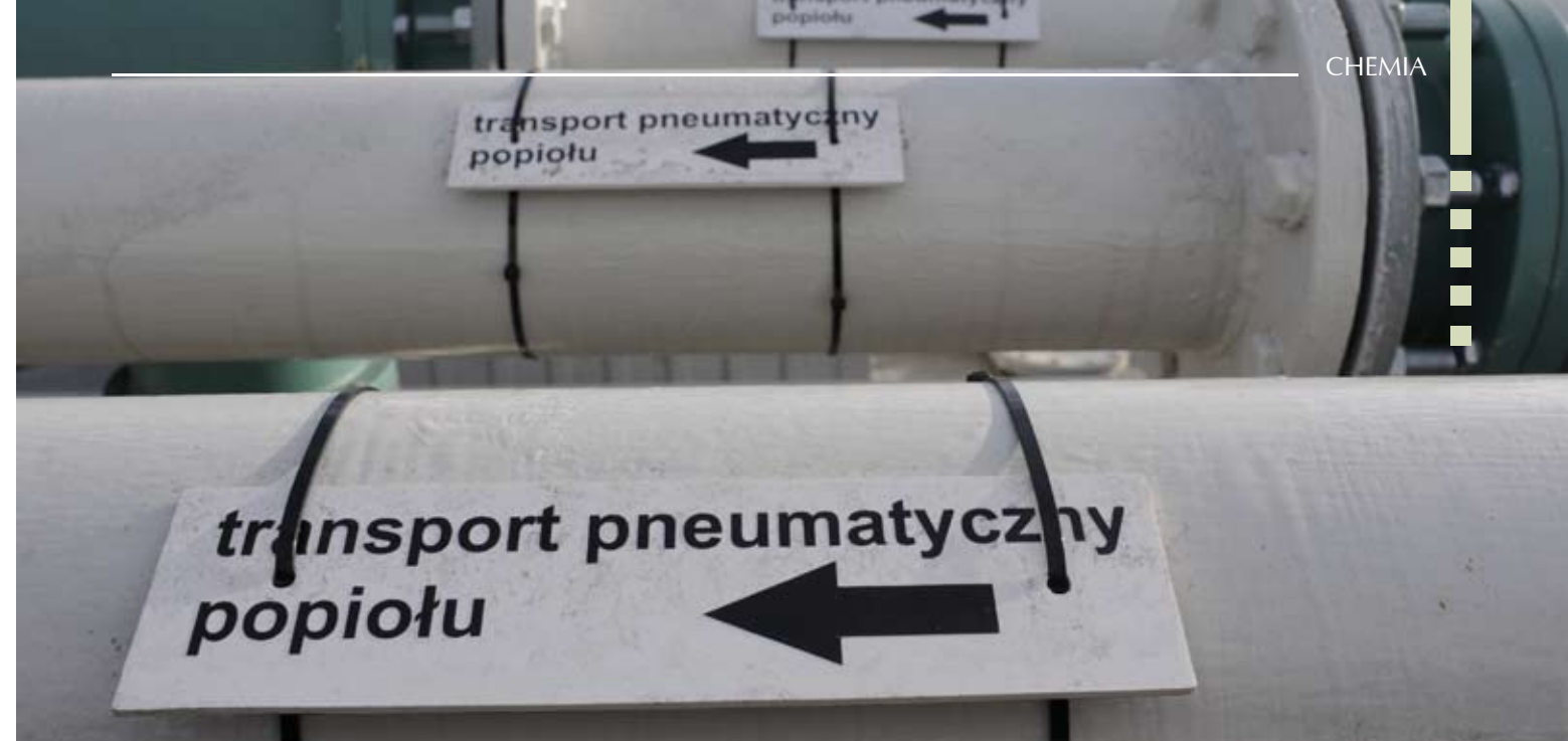
Instalacja do odbioru popiołu
