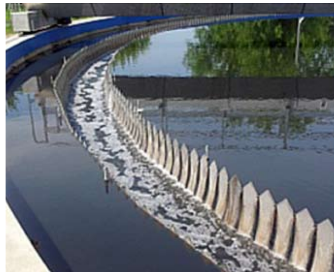
Osadnik wtórny po modernizacji (2012)
