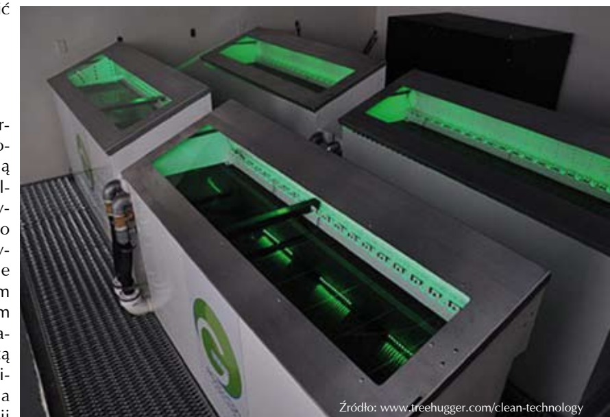
Rys. Rewolucyjne ekologiczne chłodzenie serwerowni
