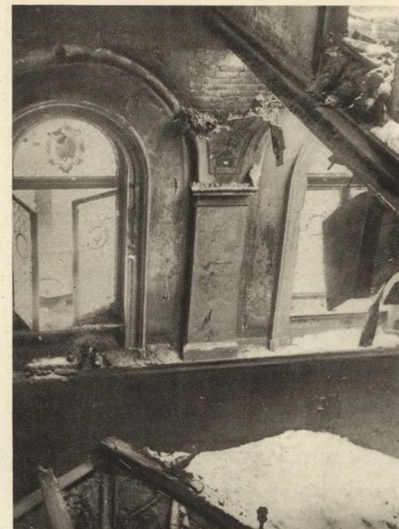
Spalona Pocztą. Klatka schodowa.
