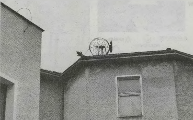
Przy silniejszym podmuchu wiatru przedzewiała konstrukcja może runąć na ulicę
