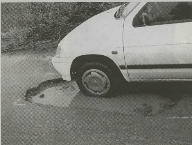
Po wpadnięciu w wyrwę można uszkodzić koło i zawieszenie auta
