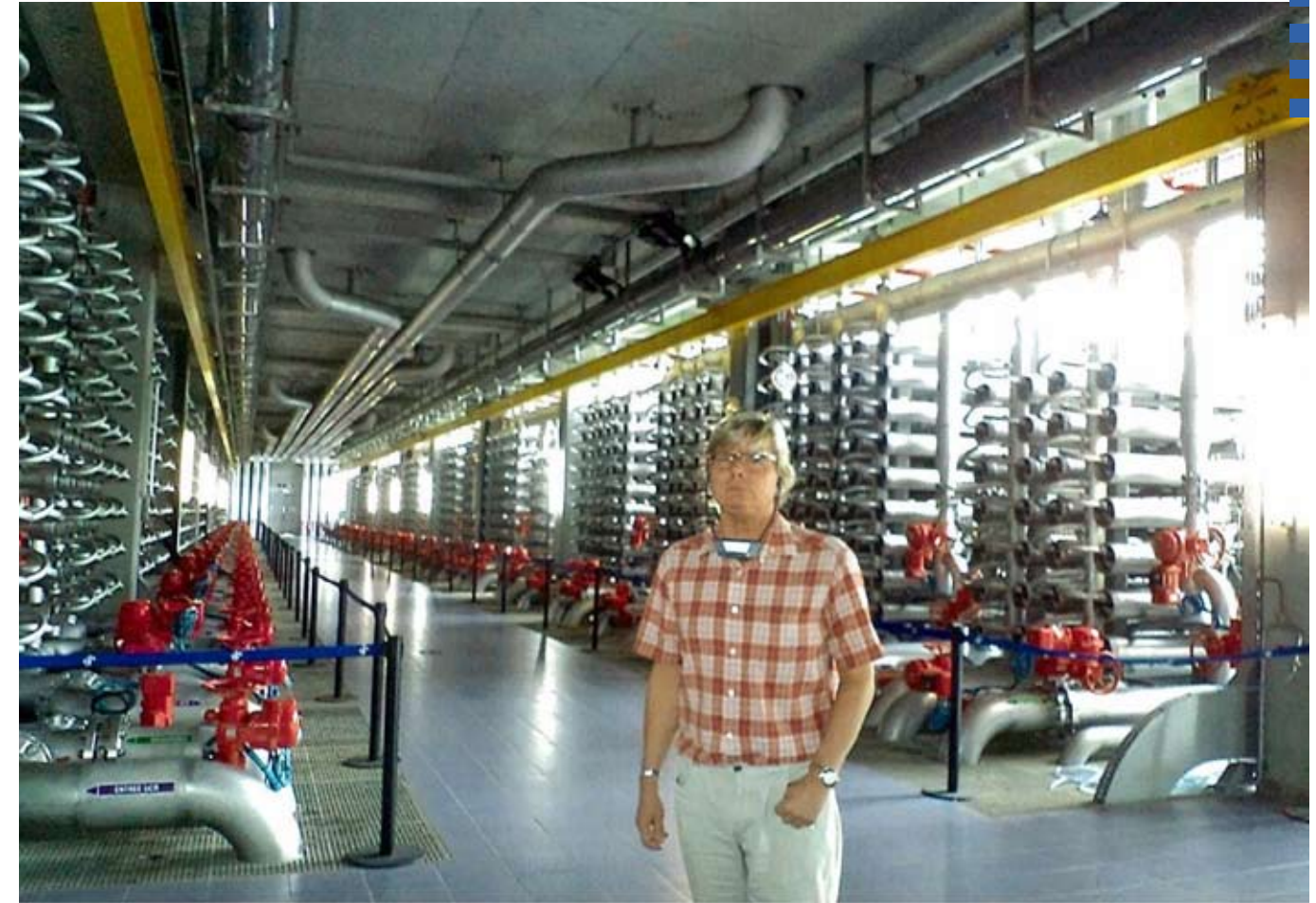
Autor na tle systemu nanofiltracji w Méry sur Oise
