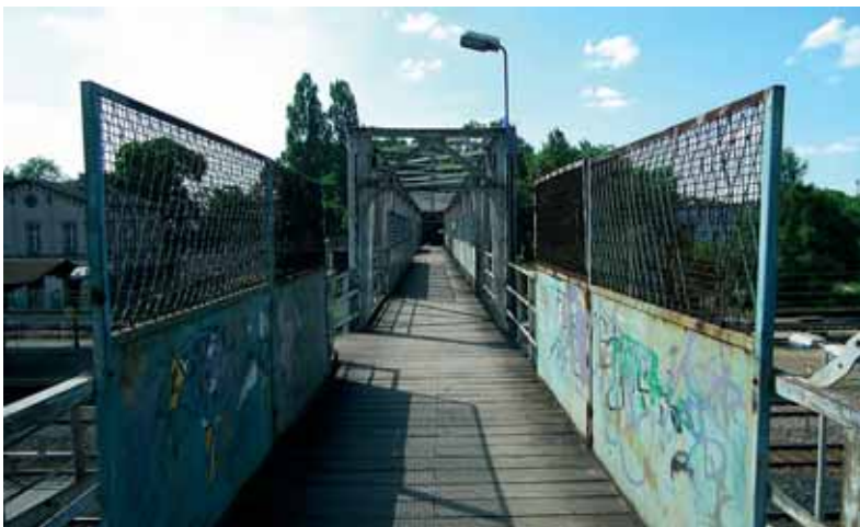
Strzemieszycka kładka nie jest jedyną własnością kolei, której stan techniczny pozostawia wiele do życzenia.
