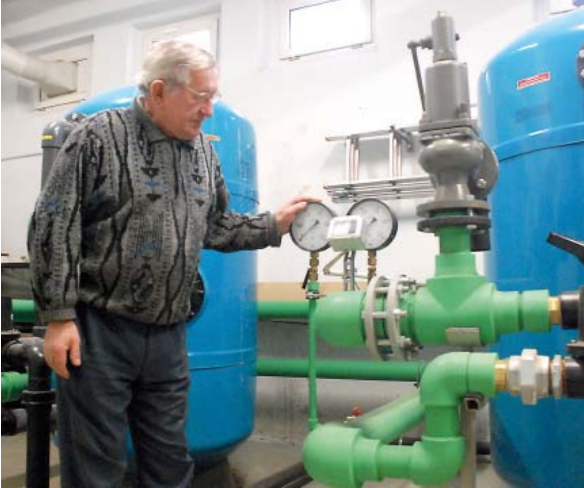
Nowoczesne, ekologiczne i energooszczędne urządzenia grzewcze montowane są w kotłowniach szkół poddanych termomodernizacji. Na zdjęciu nowa kotłownia w Gimnazjum nr 4.
