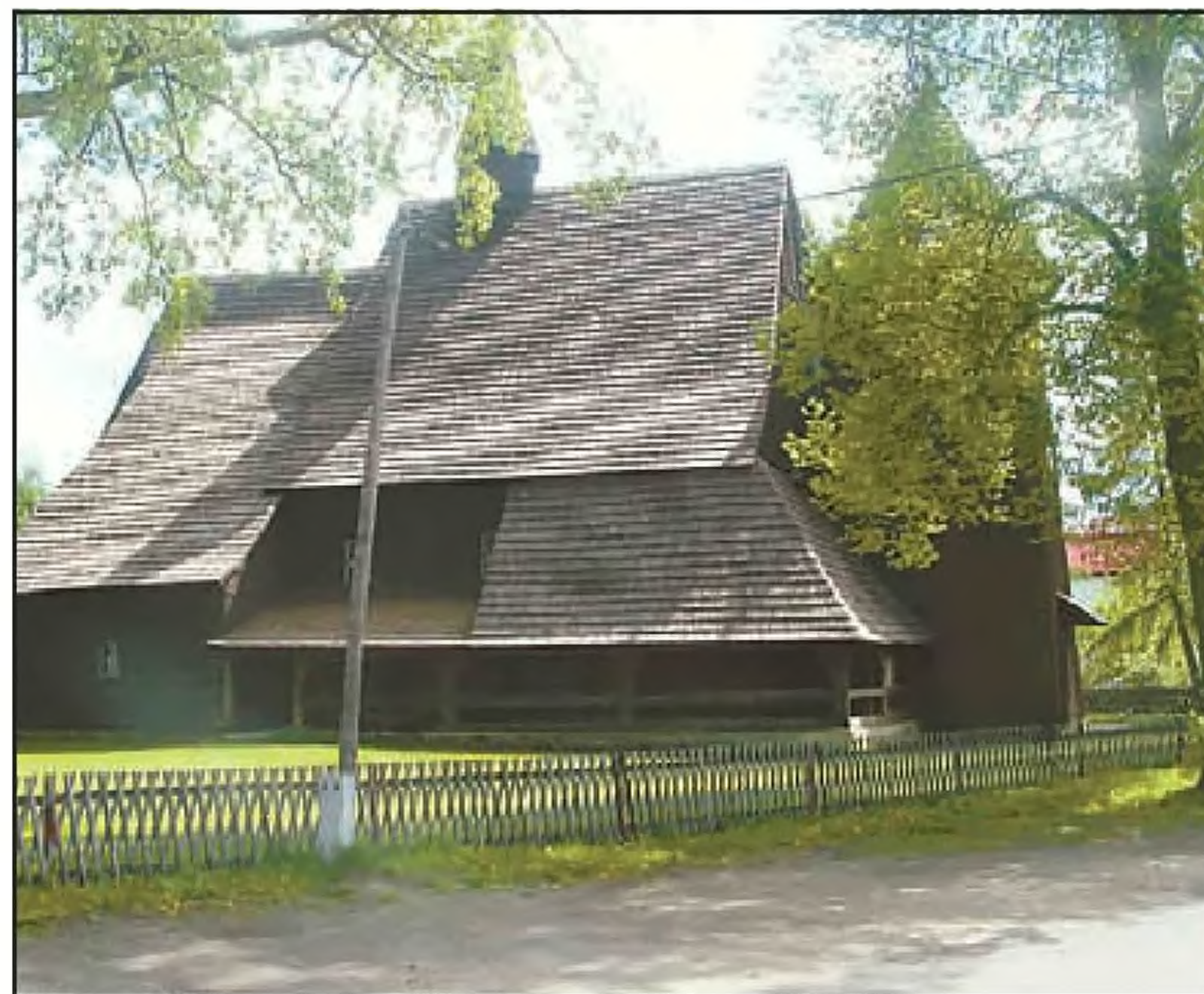
Kościół w Chocianowicach wymaga szybkiego remontu
