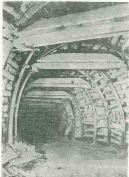
Rys. 302. Zapory pyłowe w chodniku
