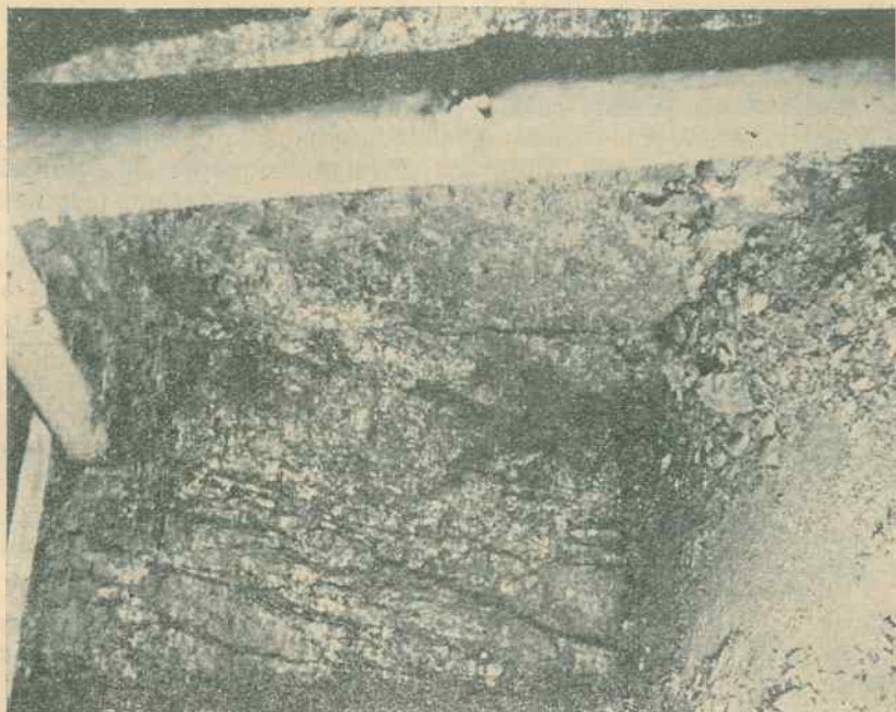
Pęknięcia w ośrobie ścianowym
