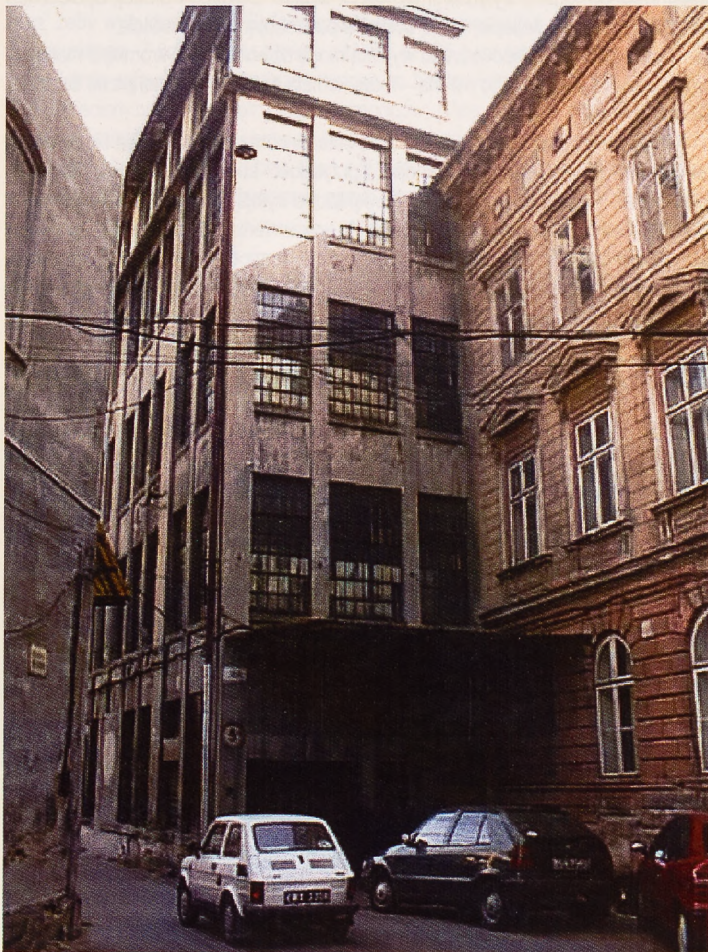
W architekturze teraz jest modny konstruktoryzm, a u nas to jest – czekające na inwestora i remont budynki ZPW Finex.
