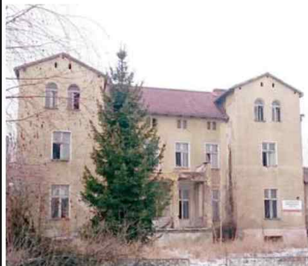
Kolejny budynek, który ulega degradacji
