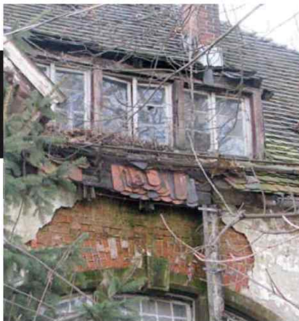
Pozrywane rynny i odpadające dachówki
