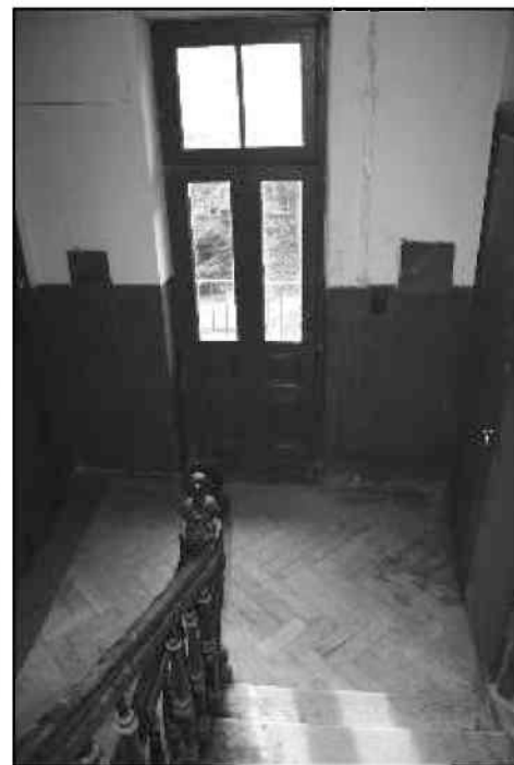
Drzwi wyjściowe na podwórko kamienicy przy ul. Św. Zofii 8a. Kolorowych szybek już nie ma.
