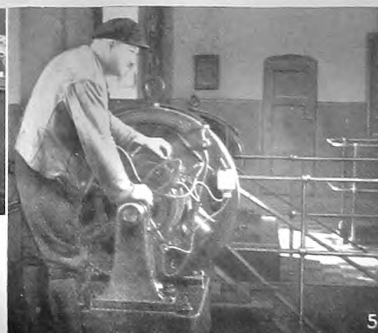
1. Vollautomatische Druckstrahl-Flaschenwaschmaschine. — 2. Vollautomatische Flaschenabfüllmaschine. — 3. Flaschenlagerkeller. — 4. Maschinenhaus mit Ammoniak Kondensator und Zentralschalter. — 5. Dynamo.
