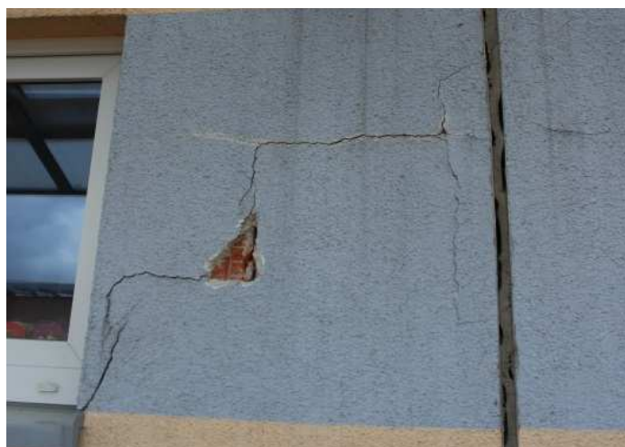
Rys. 3. Pęknięcie ściany w obrębie dylatacji
