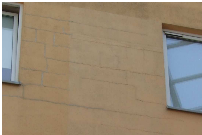
Rys. 2. Pęknięcia filarów międzyokiennych
