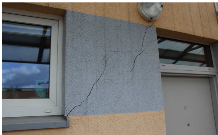
Rys. 6. Spękania ściany na skutek odkształceń termicznych
