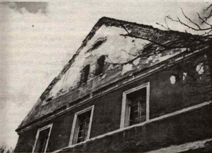
W momencie kupna przez NTSK budynek nadawał się do rozbiórki.
