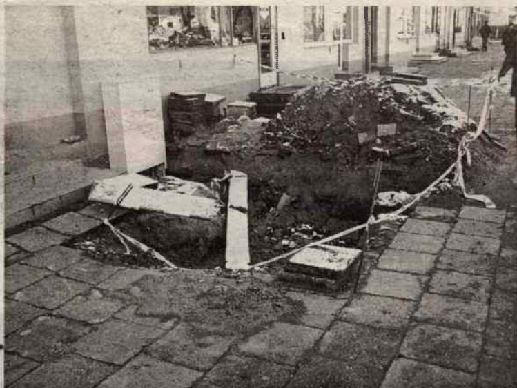
Taka dziura może być niebezpieczna dla przechodniów
