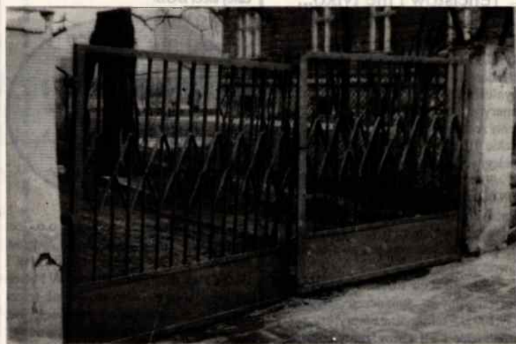
... a na Ogrodowej ogrodzenie wymaga remontu.
