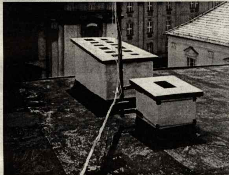
Wylot wentylacji po pierwszej przeróbce
