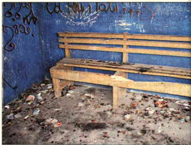
Wykonanie tego zdjęcia kosztowało nas sporo samozaparcia. Nie będziemy rozwijać tego stwierdzenia. Fotografia przystanku mówi sama za siebie.
