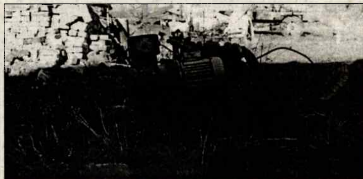
Pompa do opróżniania szamba wprost na pole
