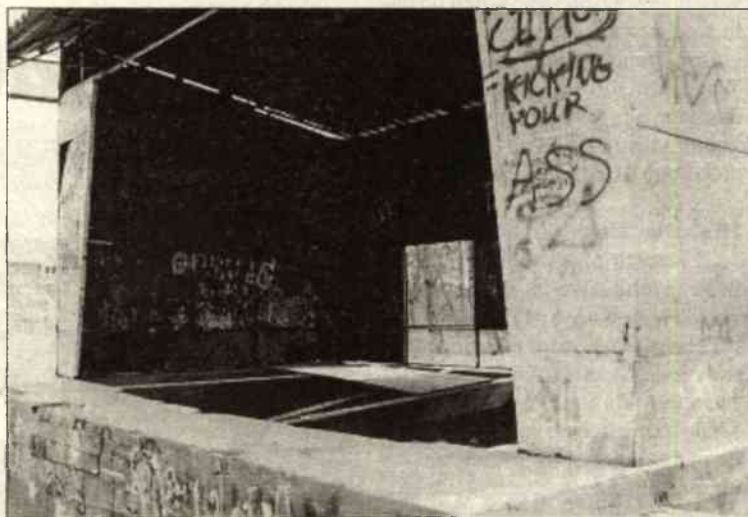
Obiekt nadaje się tylko do wyburzenia
