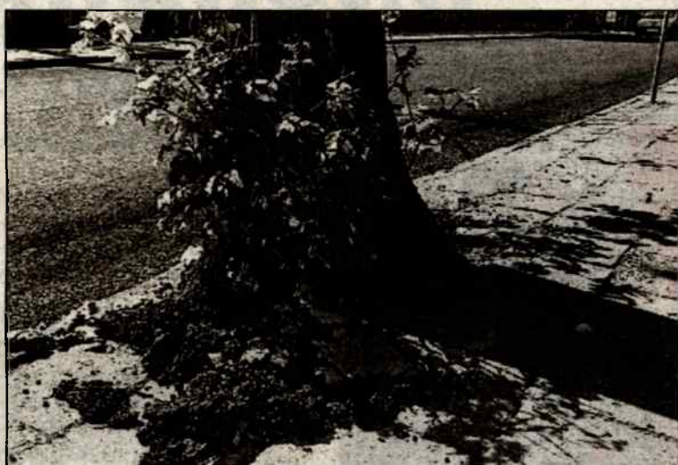
Wykonawca resztkami asfaltu wypełniał dziury w chodniku
