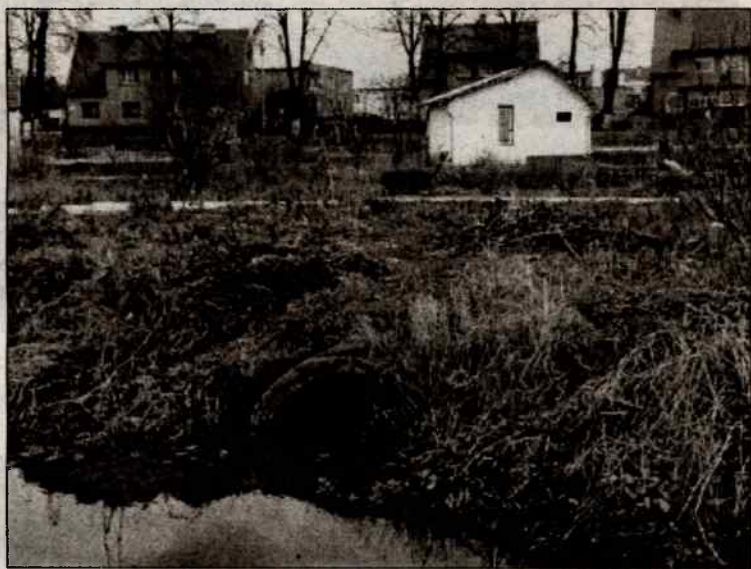
Tą rurą wydostają się ścieki
