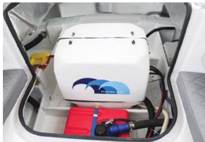
Generator prądu zapewnia niezależność.
