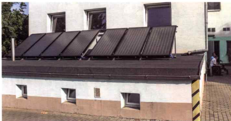
Solary na budynku DSS
