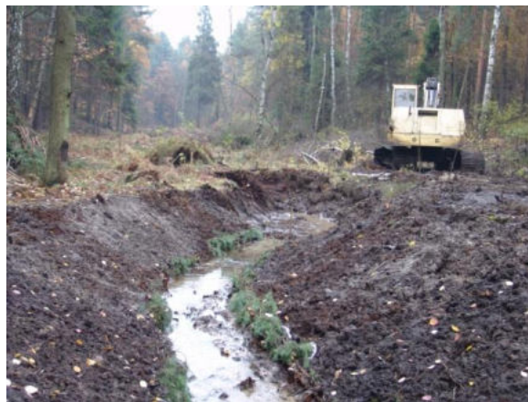
Ryc. 4.19. Dewastacja koryta bezimiennego ciek w Nadleśnictwie Katowice. Fot. G. Chwoła (27 października 2007 r.) Fig. 4.19. Devastation of the unnamed riverbed in the Katowice Forest District. Photo by G. Chwoła (27 October 2007)
