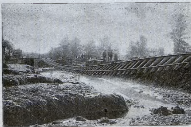
Hochwasser vom 9.—11. Juli 1903 Zerstörter Eisenbahndamm an der Papierfabrik Rothseß.
