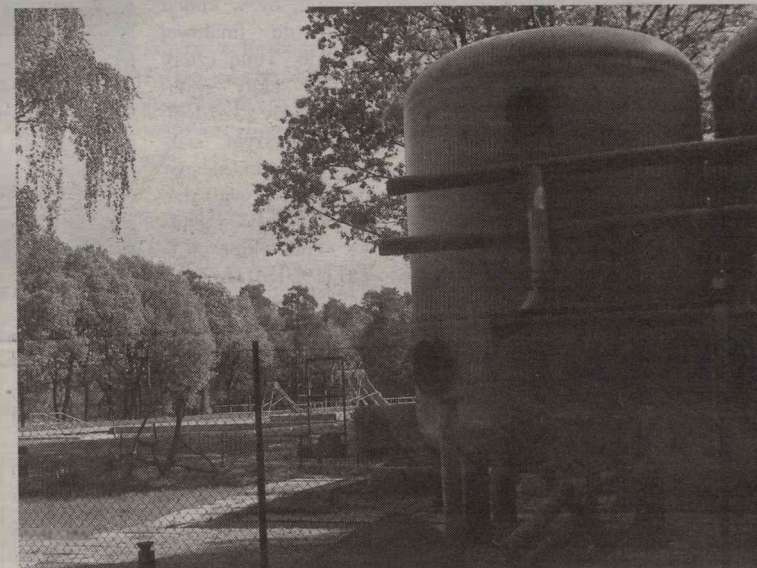
Stare zbiorniki filtracyjne wymagają wymiany
