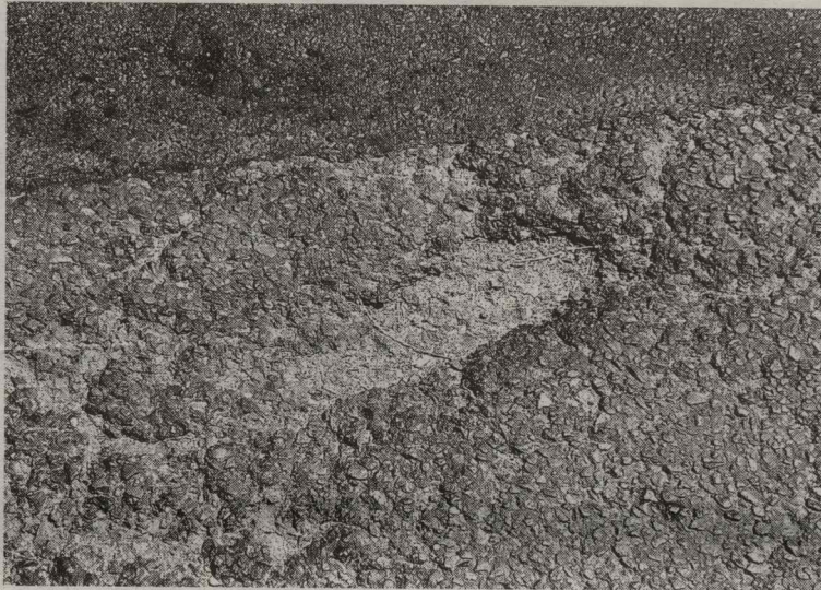
Po zakończeniu remontu na drogach wciąż są dziury
