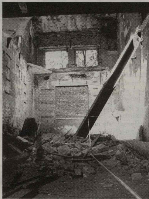
Tony gruzu wpadły do środka hali. 40-letni mężczyzna zginął na miejscu.
