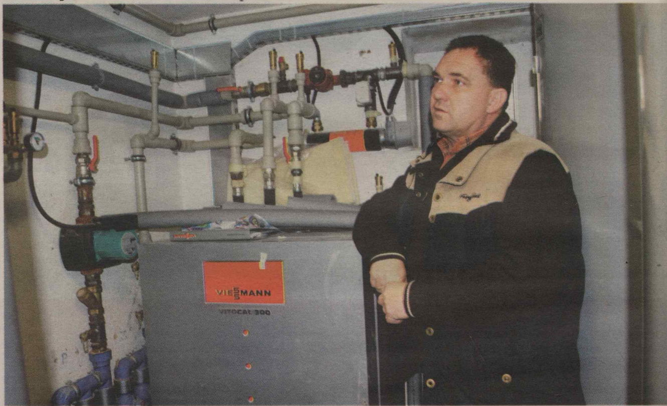
Tak wygląda kotłownia energooszczędnego budynku.
