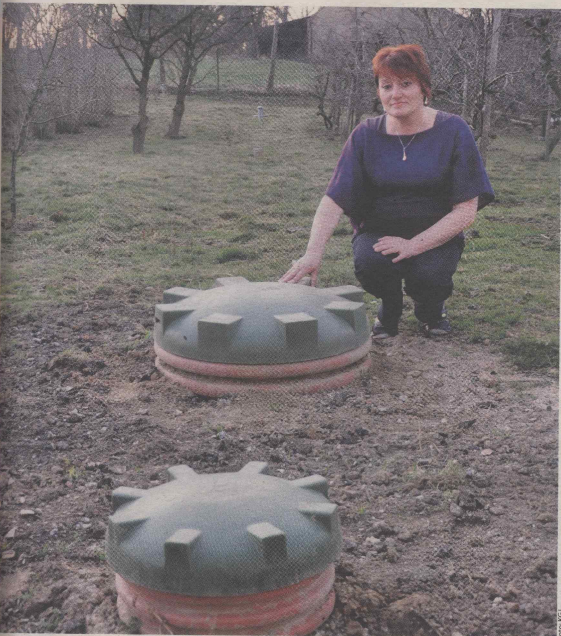
Większa część przydomowej oczyszczalni ścieków znajduje się pod ziemią. Na powierzchni niewiele widać.
